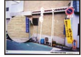
中原水道商会外壁の弾痕
